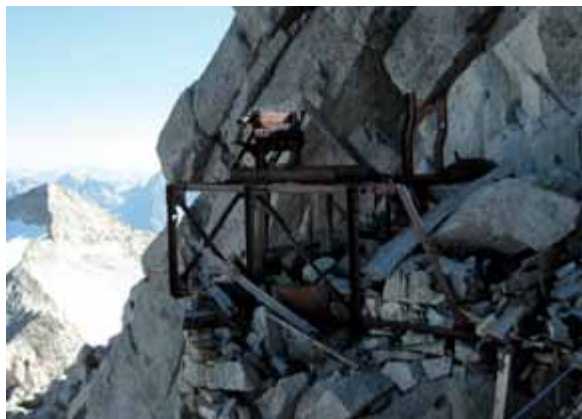
Teleferica a contrappeso italiana sul Corno di Cavento Settembre 2009
